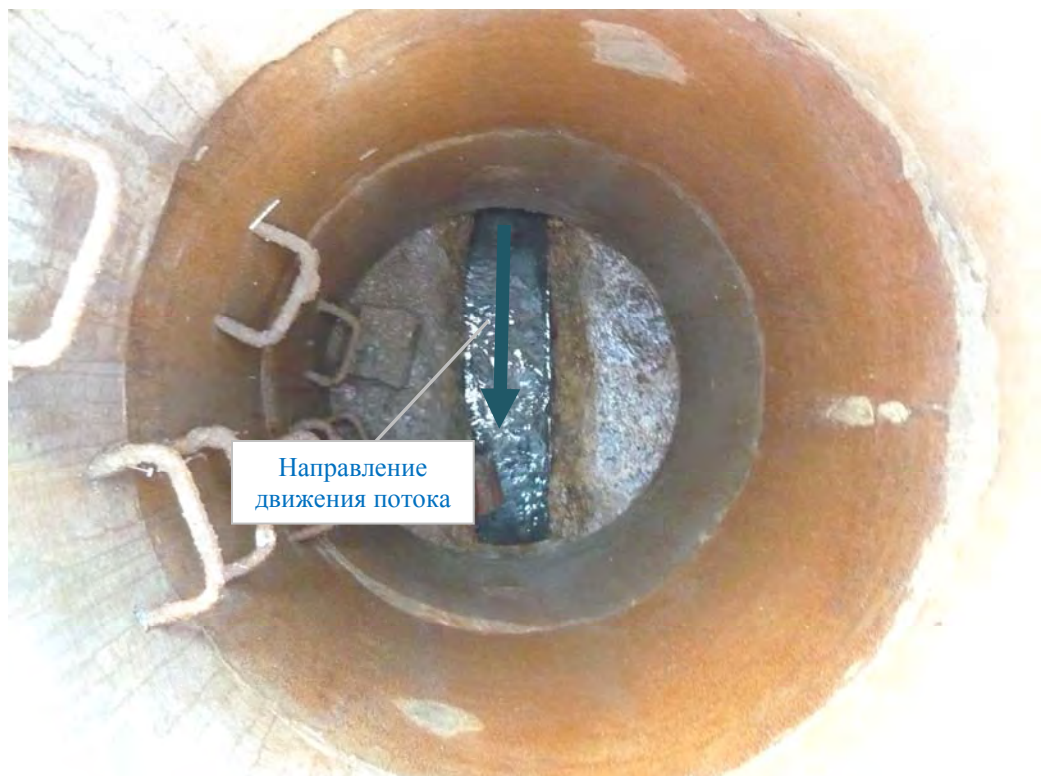
Рис. 2. Состояние колодца КК() и направление потока
