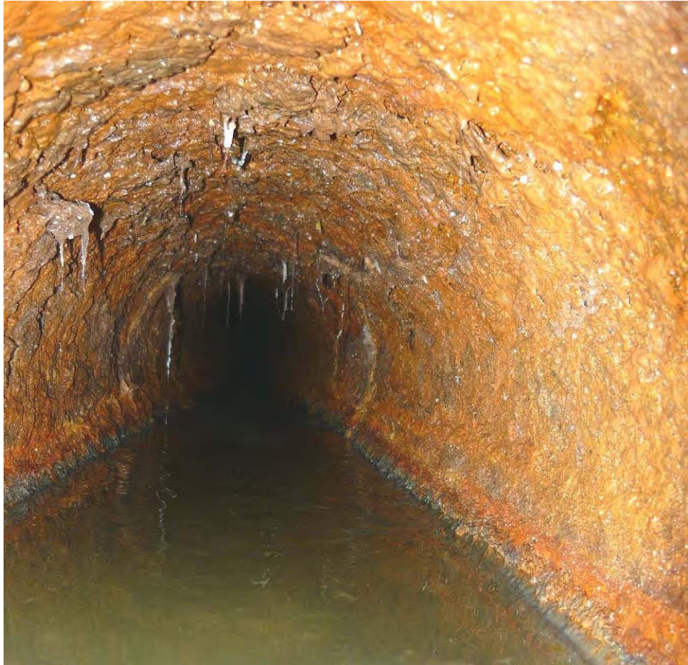
Рис. 3. Колодец КК(+), состояние коллектора на входе в колодец
